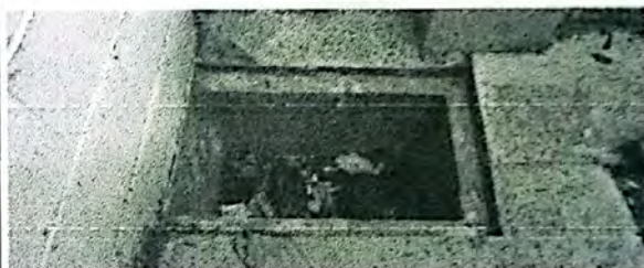
Foto 4: Cajas de registro sin tapadera exterior módulo 2
