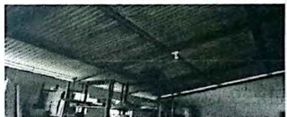
Foto 4: Techo de lamina acanalada en mal estado modulo 1
